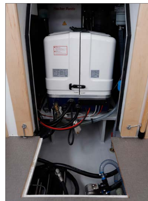
▲ La coque du groupe électrogène s'ajoute à l'isolation phonique de la cale moteur dans laquelle il prend place.
