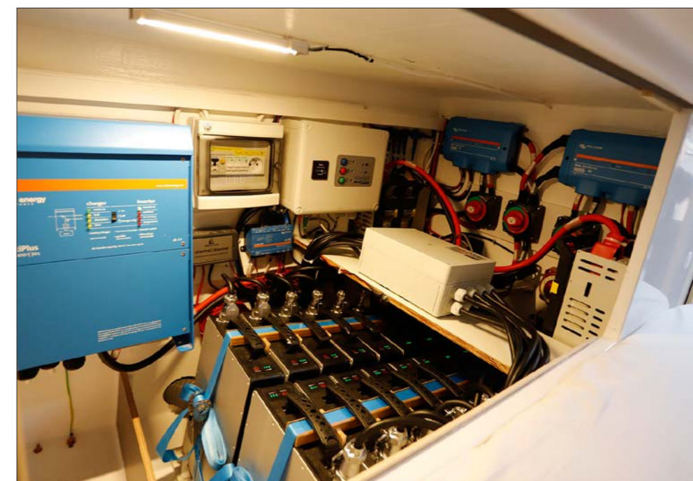
▲ Le parc de batteries lithium, derrière la cale moteur, c'est à la fois le nerf de la guerre et de loin le plus gros poste du budget de la motorisation électrique (voir tableau).
